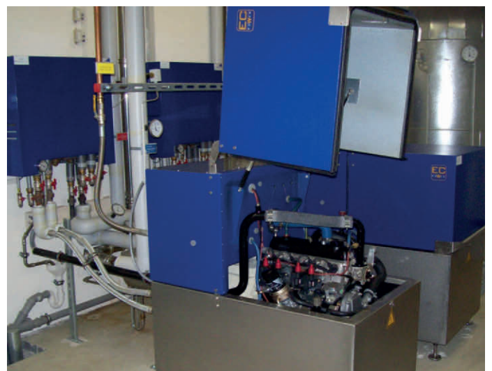
BHKW, derzeit in vier Häusern im Einsatz
