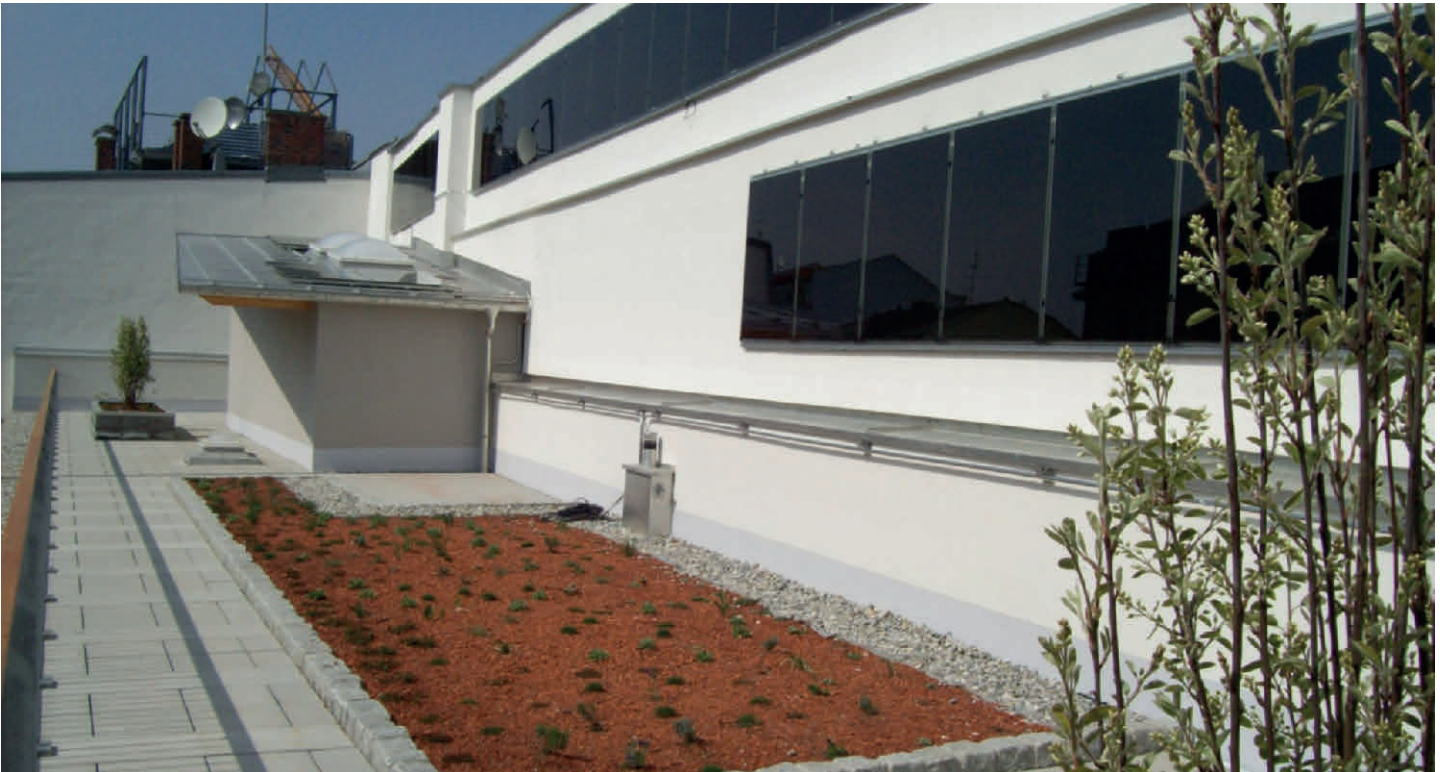
PV-Anlage auf der Dachterrasse der Pariser Straße 11
